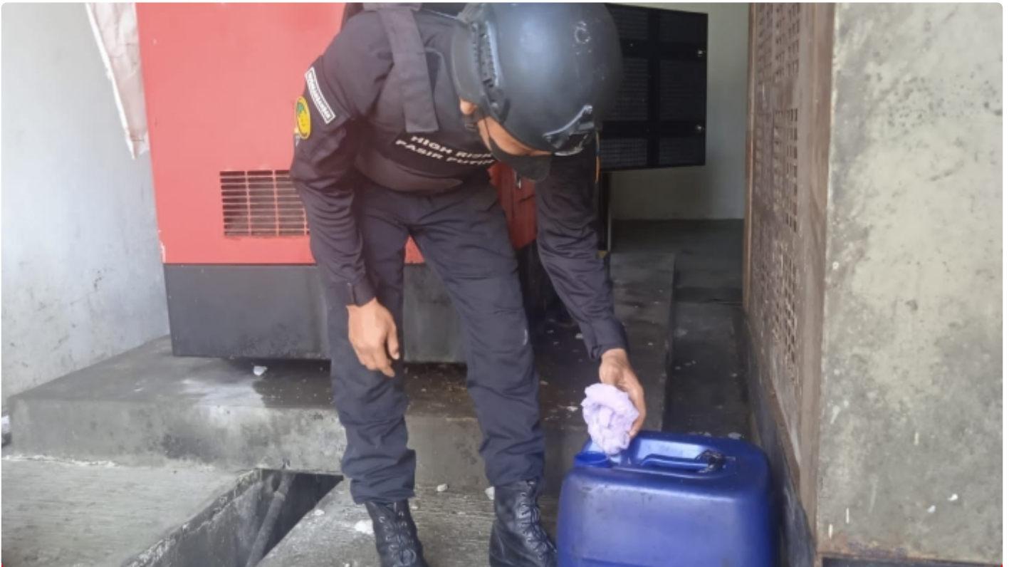
Petugas Lapas Pasir Putih melaksanakan pengecekan bahan bakar solar untuk mesin genset
